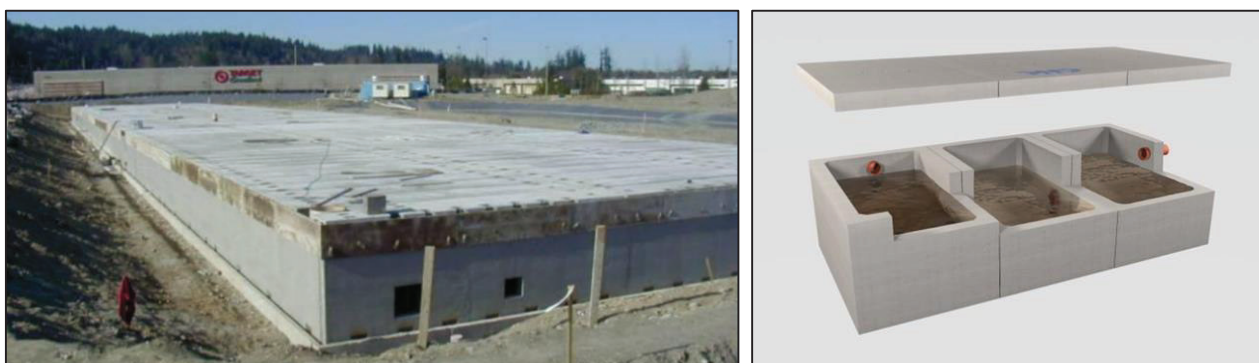
Figura 6-20: Esempio di opere di laminazione sotterranee costituite da vasche in cemento armato gettata in opera (a) e prefabbricate (b).
